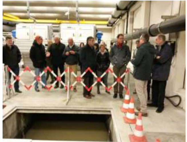
Einer von zwei Abwasserkanälen
